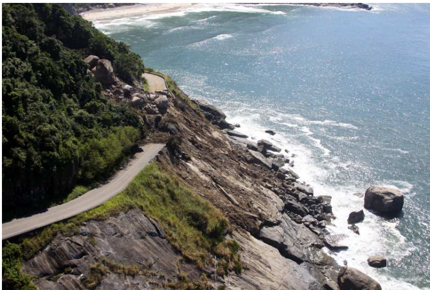
Figura 24: Escorregamento de rocha na Estrada da Guanabara - Prainha (06/04/10)
