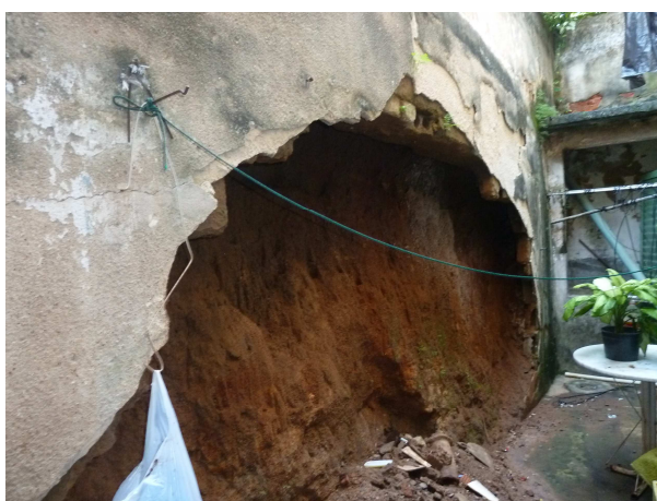
Figura 23 – Deslizamento de Solo em Talude de Corte com ruptura de muro divisório - Complexo do Alemão
