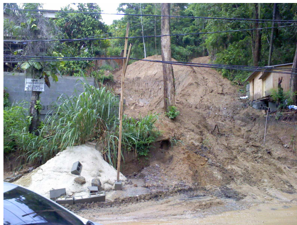
Figura 22 – Deslizamento de Solo em Talude de Corte – Freguesia - Jacarepaguá
