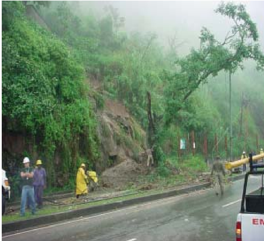
Deslizamento de solo e rocha em talude de corte da via
