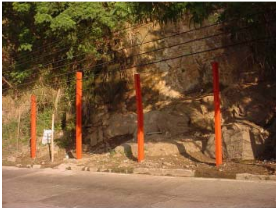
Deslocamentos de blocos de rocha contidos por estrutura de impacto
