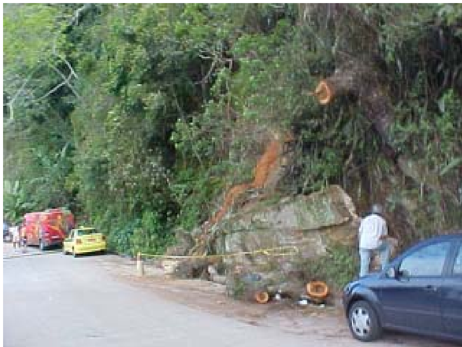
Deslocamentos de blocos de rocha alterada
