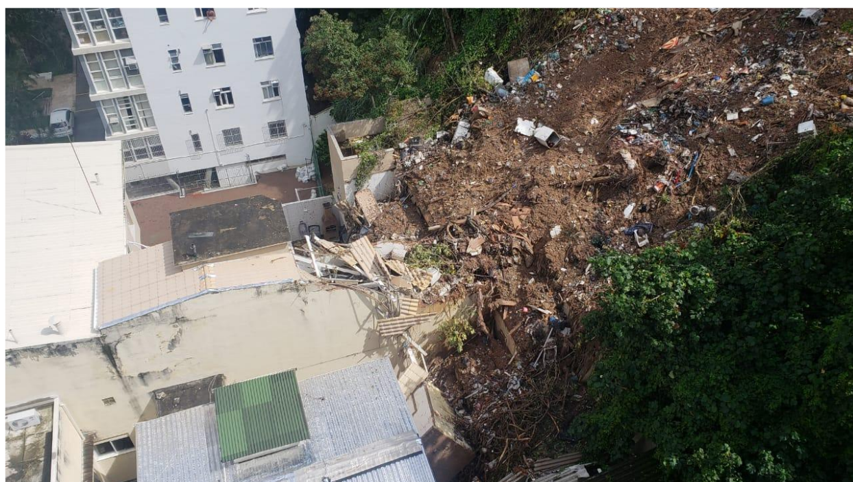
Figura 10: Escorregamento translacional que destruiu a parte dos fundos dos prédios na rua Barão da Torre. Fonte: Fundação Geo - Rio.
