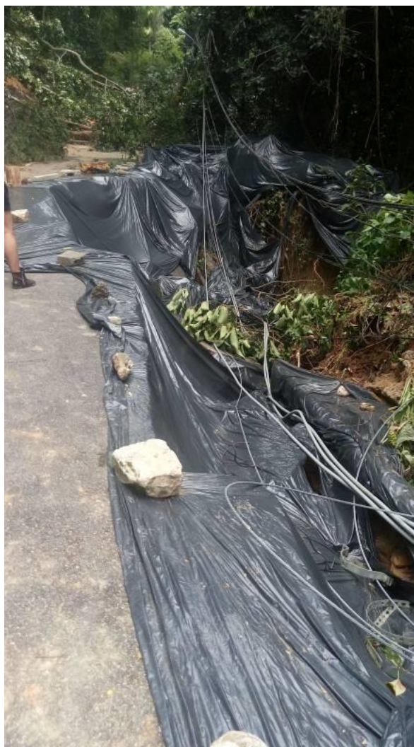
Figura 5 - Observa-se pavimento da Estrada das Canoas comprometido após escorregamento. Ao fundo observa-se escorregamento na encosta a montante da via. Fonte: Fundação Geo - Rio.
