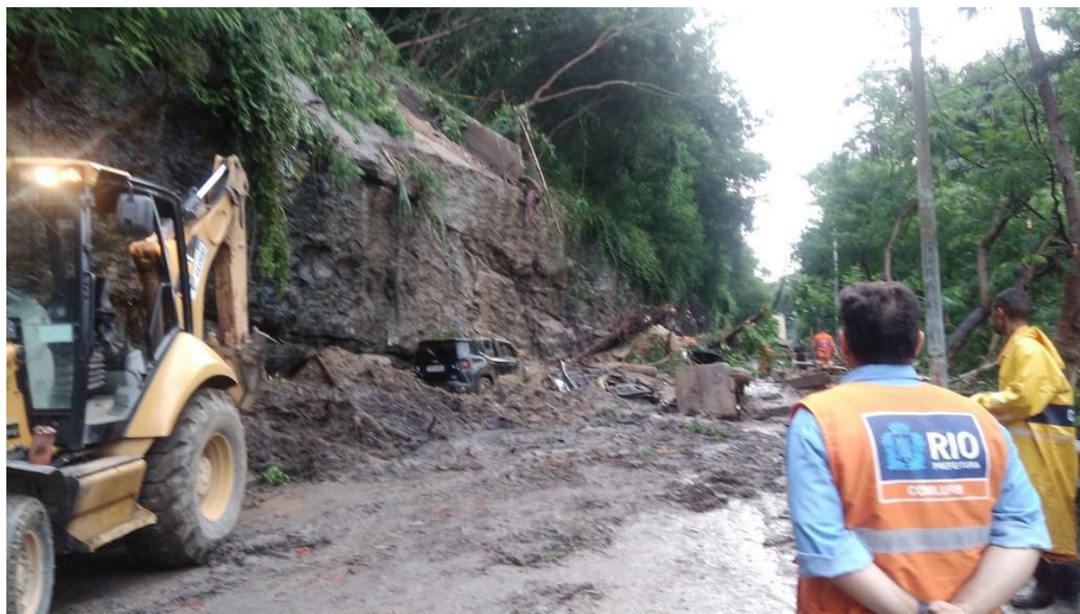
Figura 12: Escorregamento principal da Avenida Carlos Peixoto, com atingimento de vários veículos na via.
