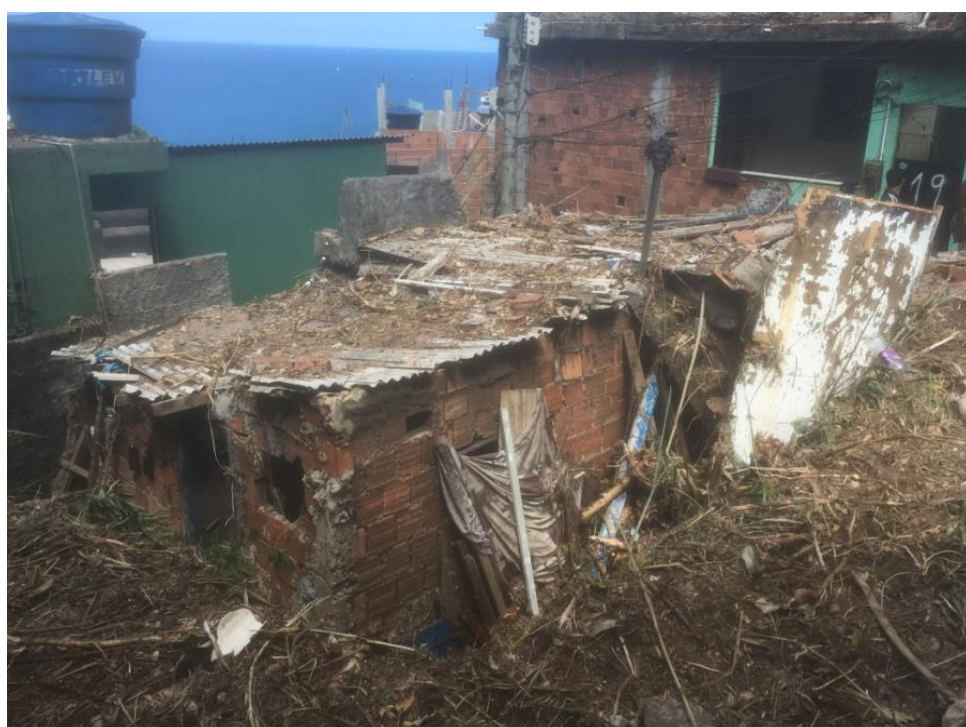
Figura 4: Uma das moradias atingidas pelo fluxo de detritos na comunidade. Fonte: Fundação Geo - Rio.
